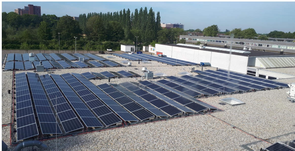
930 zonnepanelen dragen bij aan de verdere verduurzaming van het pand aan de Onderwijsboulevard
